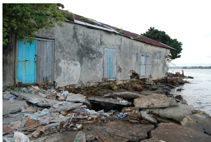
Case d'habitation quasiment détruite et menacée par l'augmentation du niveau de la mer à Morondava, SW Madagascar. Plusieurs cases d'habitation sont détruites chaque année lors des saisons cycloniques. Photo : MEF/SCECC.
